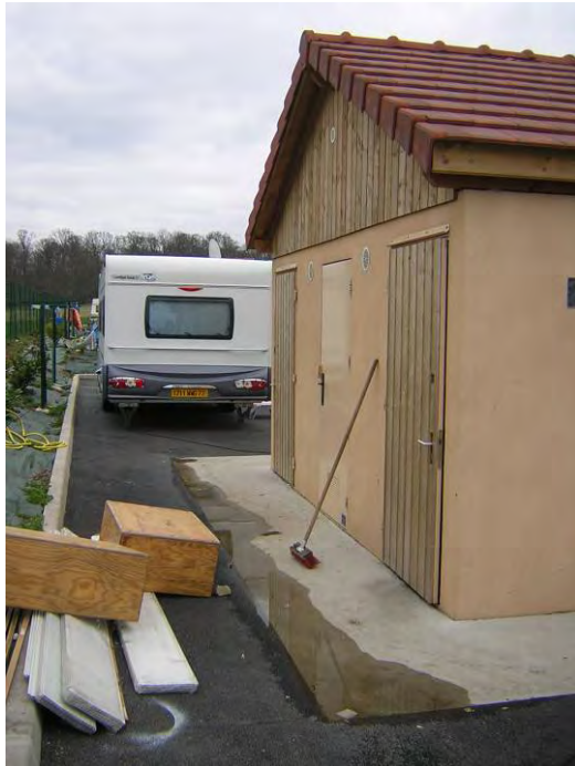
Porte de WC permettant un accès discret mais évacuation des eaux mal calculée
