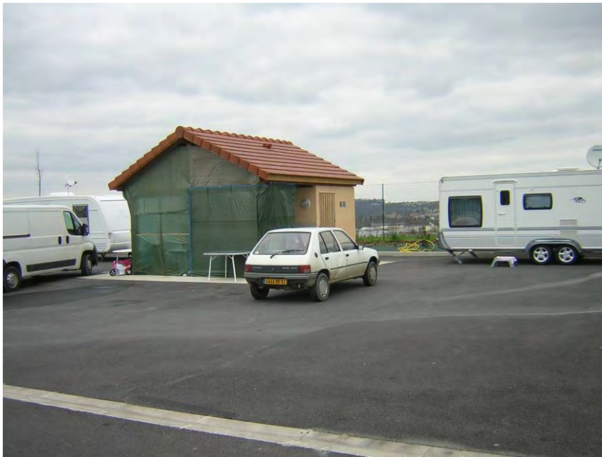
Auvent d'un bloc sanitaire soumis aux pluies battantes et aux vents dominants
