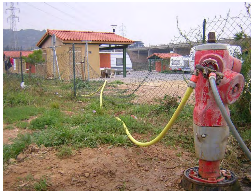
Poteau incendie non sécurisé
